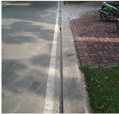
Gambar 3. Kondisi jalan di kawasan
