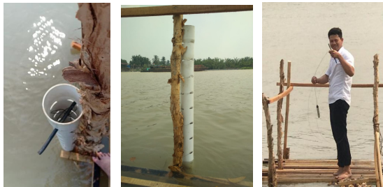
Gambar 4 Pemasangan Hobo Water Level pada Pipa PVC
