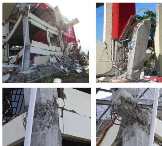
Gambar 1. Keruntuhan gedung perkantoran tiga tingkat di Universitas Tadulako (sumber: foto oleh Syafri Wardi)
