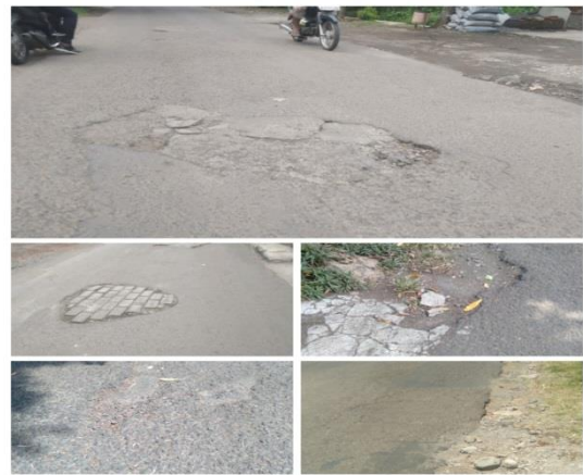
Gambar 4. Kondisi fisik jalan
